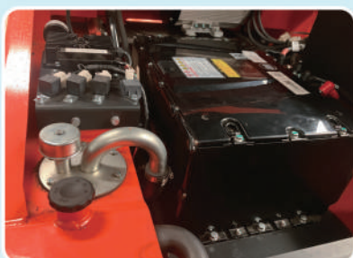
La comprobación del nivel de aceite hidráulico resulta sencilla.
